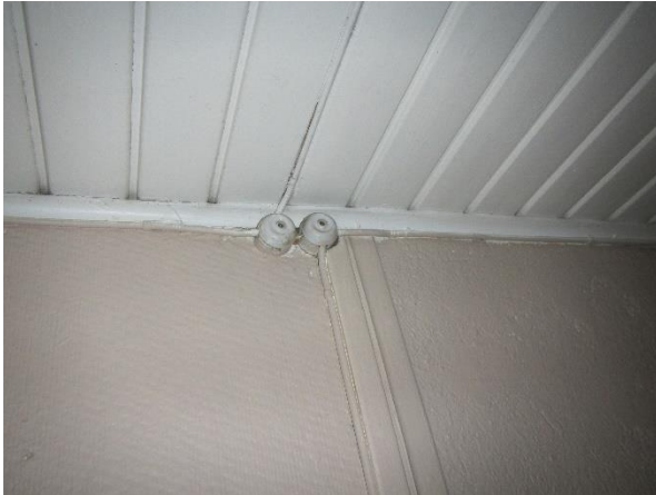
Kuva 45: Näkymää vanhasta asennuskalusteesta
