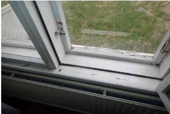
Kuva 9: Ikkunoiden maalipinnoissa havaittiin runsaasti maalipinnan irtoamista.
