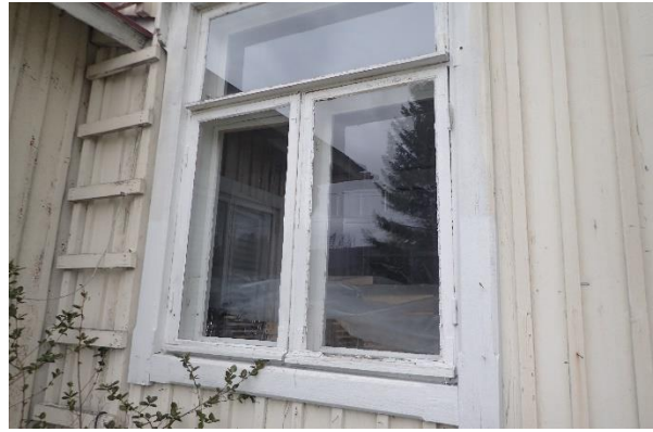
Kuva 10: Ikkunoiden maalipinnoissa havaittiin runsaasti maalipinnan irtoamista.
