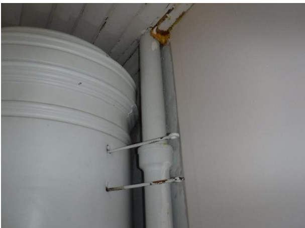
Kuva 30: Rakennuksen viemärit ovat näkyviltä osiltaan valurautaa.
