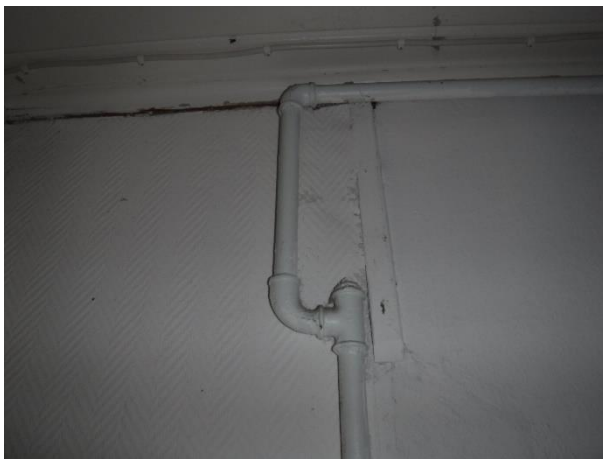
Kuva 21: Päärakennuksen lämmitysverkosto on teräsputkesta valmistettu.
