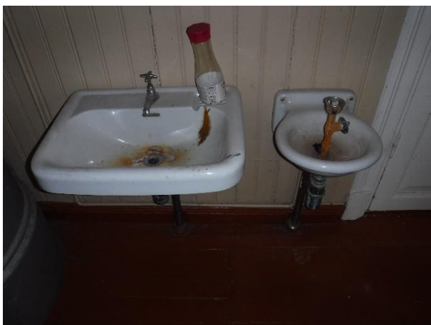
Kuva 27: Vanhoja vesikalusteita päärakennuksen eteisaulassa.
