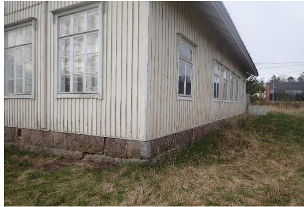
Kuva 2: Pinnat rakennuksen ympärillä ovat joko tasaiset tai ne kallistavat lievästi rakennuksesta poispäin.
