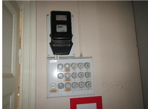
Kuva 37: Näkymää 1970-luvun ryhmäkeskuksesta
