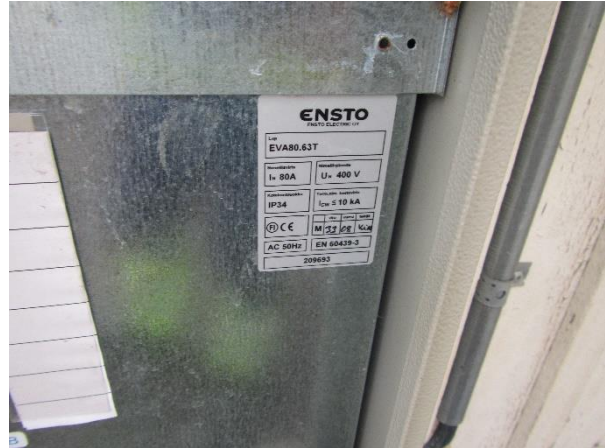
Kuva 35: Näkymää pääkeskuksen selitteestä
