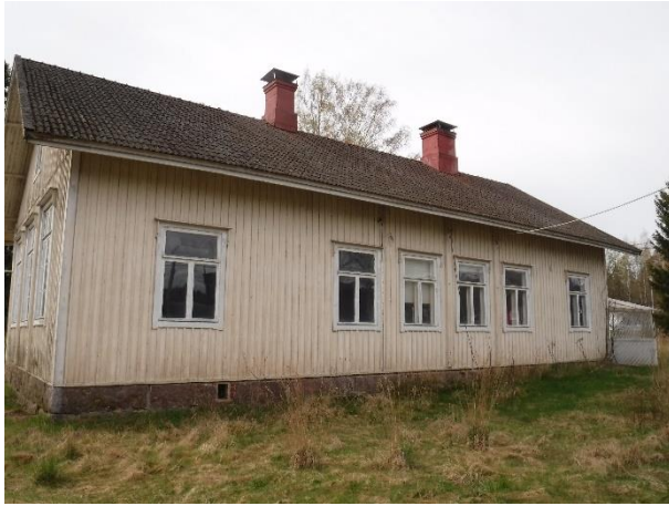
Kuva 31: Rakennuksissa ei ole kattosadevesien ja piha-alueen pintavesien poistoja
