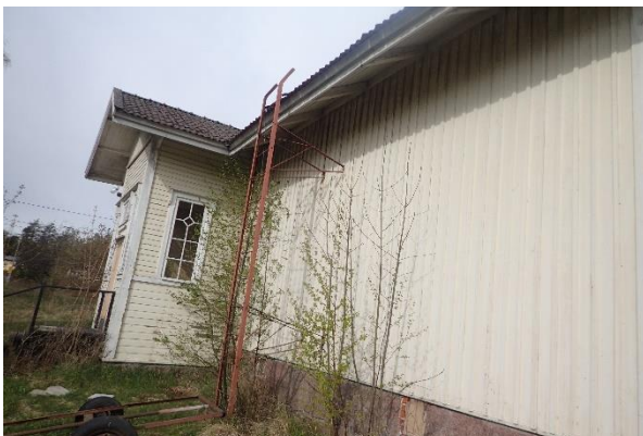
Kuva 14: Talotikkaiden pintakäsittely on huono ja niissä havaittiin ruostetta ja niistä puuttuu lukittava kiipeämisen estävä laite.
