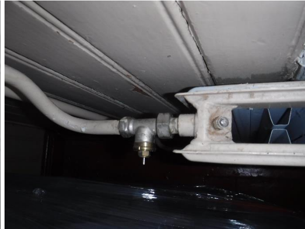
Kuva 24: Patteriventtiilistä puuttuu termostaattiosa.
