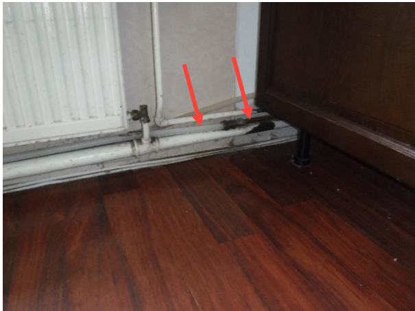
Kuva 25: Käyttövesiverkoston putket ovat kupari- ja muoviputkia.
