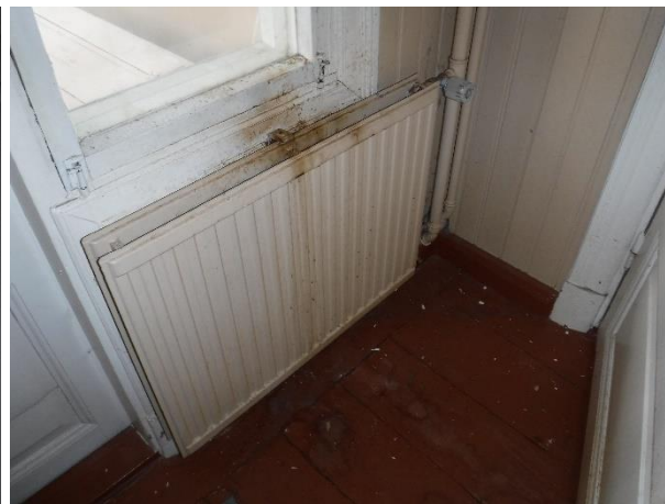
Kuva 22: Lämmityspatterit ovat teräslevytasopattereita.
