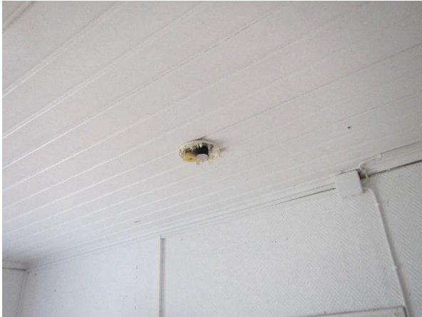
Kuva 51: Näkymää vanhasta palovaroitimesta
