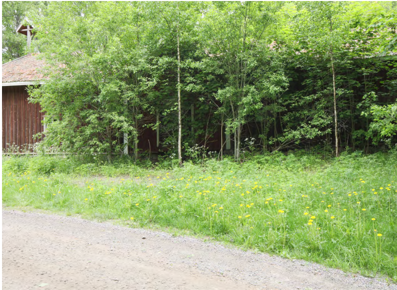
← Makasiinirakennuksen eteläisivun itäosa on paljolti kasvillisuuden peitossa.
