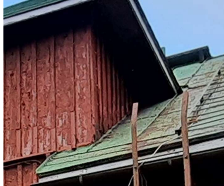
Vesikatteen ylösnosto puutteellinen
