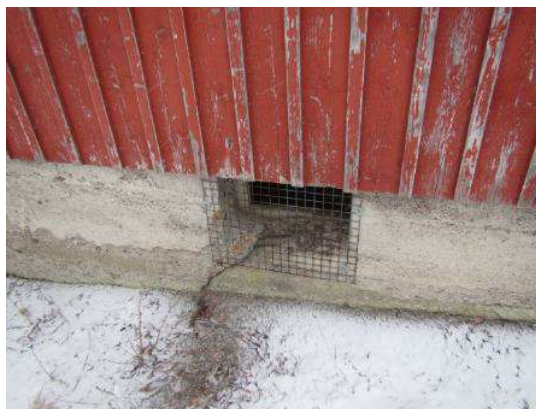
Kuva 18. Laajennusosan tuuletusluukku ja harva verkotus.
