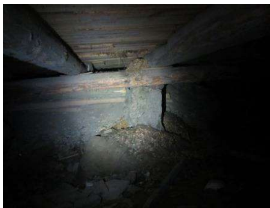
Kuva 14. Yksittäinen alapohjan sortuma alkuperäisen alapohjan osalla.
