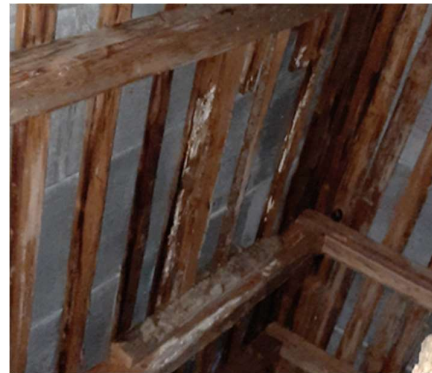
Kondensoituneen kosteuden aiheuttaman rasituksen jälkiä vesikatton alusrakenteissa.
