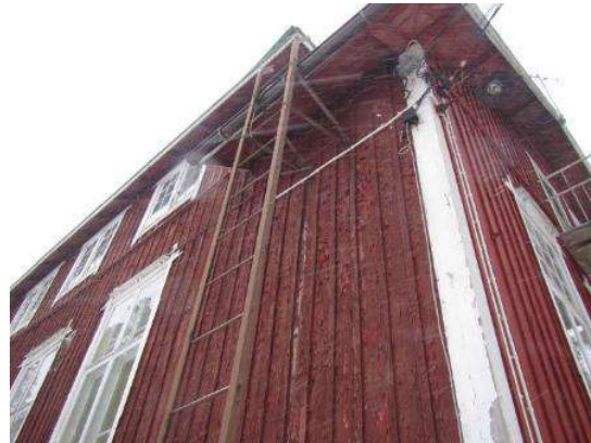
Kuva 30. Varsinkin eteläjulkisivulla maalipinnoitteet ovat huonokuntoisia.
