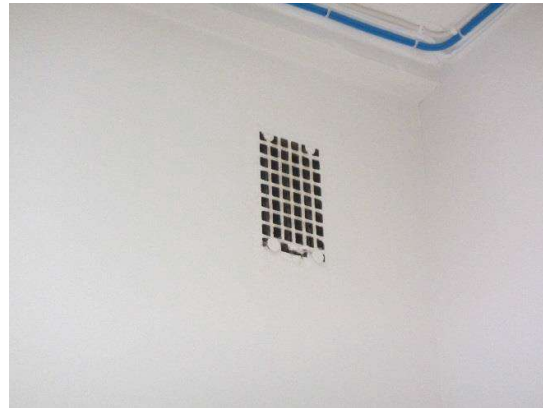
Kuva 80. Painovoimaisen ilmanvaihdon hormipoisto
