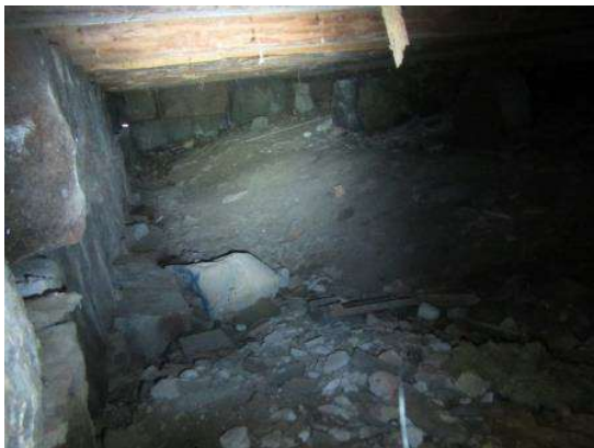
Kuva 23. Rakennusjätettä alapohjatilassa, lisäksi pohjamaassa on epätasaisuutta ja kuoppaa.
