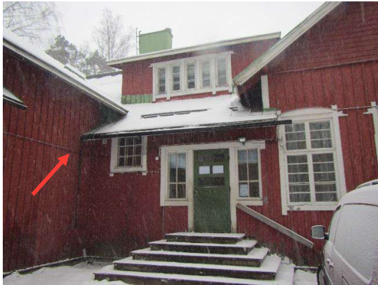
Kuva 75. Kattosadevedet vaativat nuolen osoittamassa kohdassa syöksytorven
