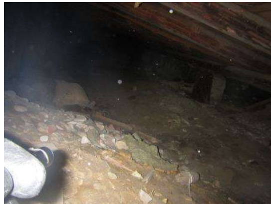
Kuva 22. Pohjalla on rakennusjätettä.
