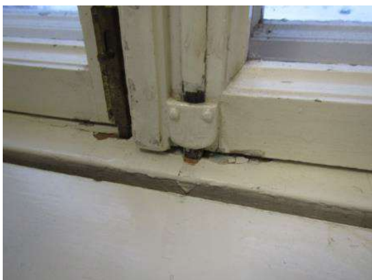
Kuva 35. Ikkunoiden sulkimille ei ole kunnon hahloja karmeissa.
