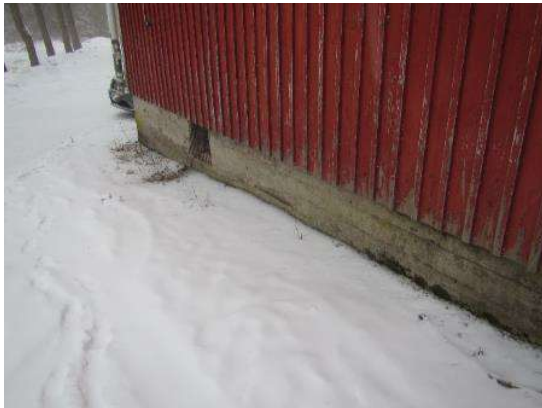
Kuva 29. Julkisivuverhoukset ovat ehjiä, mutta maalipinnat ovat kuluneita.
