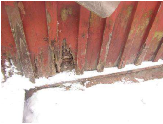
Kuva 27. Hirsirungon paikallinen vauriokohta, joka johtuu kattovesien ohjauksesta.
