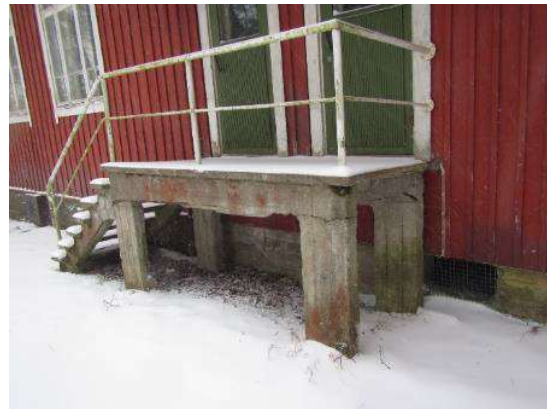
Kuva 42. Porraskorkeus on huonokuntoinen.
