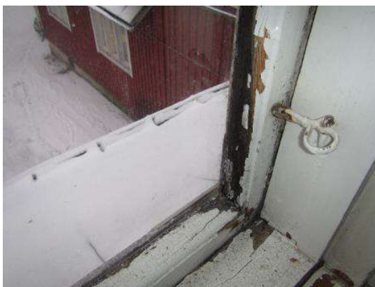
Kuva 32. Paikoin ulkopuitteet ovat lahoja.
