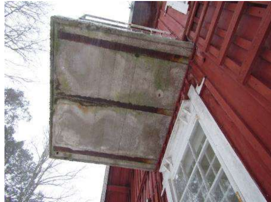
Kuva 40. Parvekelaatta on huonokuntoinen.
