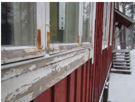
Kuva 31. Ikkunoiden ulkopuoliset maalipinnat ovat kuluneita ja kittaukset halkeilevat. Myös kulmaraudat ovat ruosteessa.
