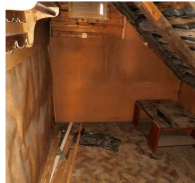
Aistinvaraisesti havaittavissa olevaa kosteutta ullakkotilan rakenteissa
