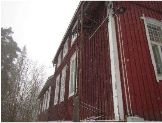
Kuva 49. Katolle johtavat tikkaat.
