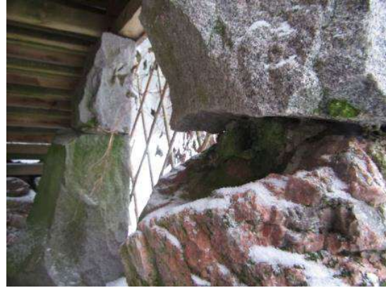
Kuva 44. Kivilatomuksen tuennat vaikuttivat riittämättömiltä.
