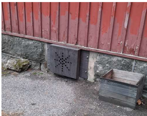
Alkuperäisen osan ryömintätilan poistoilmahuollin
