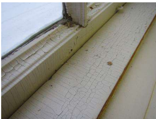
Kuva 36. Maalipinnat ovat paksuja ja halkeilevat.
