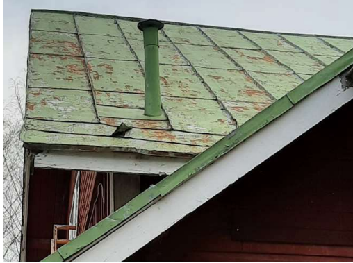
Vesikatteen paikallinen vaurio ja korroosiovaurioita
