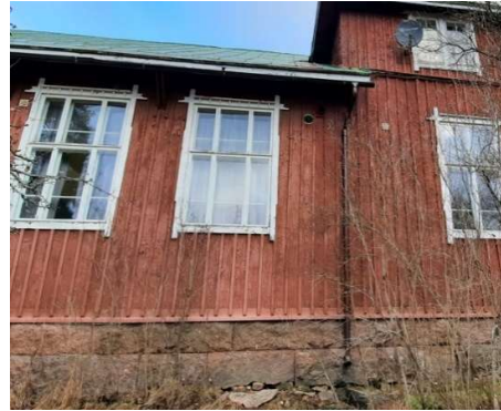
Julkisivumaalin hilseilyä laaja-alaisesti
