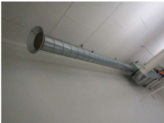
Kuva 81. Poistoilmakanava ja -pätelaite
