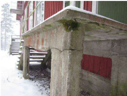
Kuva 41. Porraskorkeus on pahoin vaurioitunut.
