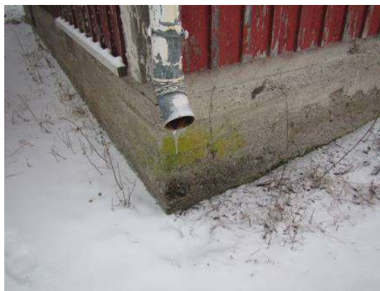
Kuva 12. Teräsbetonisokkelissa lievää pintarapautumaa.
