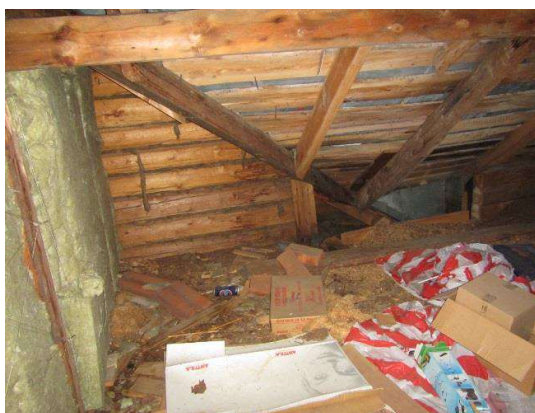
Kuva 48. Ullakolla paljon rakennusjätettä ja muuta romua.
