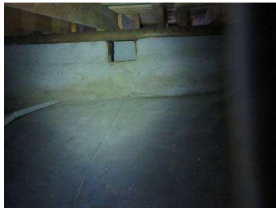
Kuva 24. Laajennusosalla maanpinnat ovat peitetyt suodatinkankaalla. Ryömintätila on siisti.
