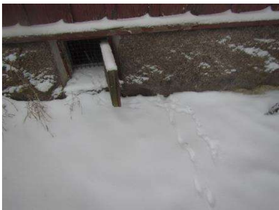
Kuva 17. Alkuperäisen osan luukuissa on harvat verkot ja kuvassa lumikon jäljet johtavat ryömintätilaan.
