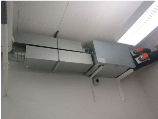
Kuva 77. Alakerran tiloissa olevat ilmanvaihtokoneet ovat kuvan mukaisia
