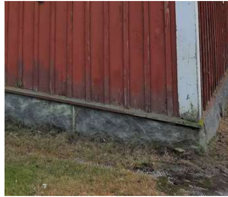
Sokkeli on paikoin matala
