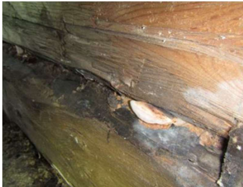
Vesikatteen jirivuodon aiheuttama lahottajasienikasvusto (WSP Finland Oy 2018).
