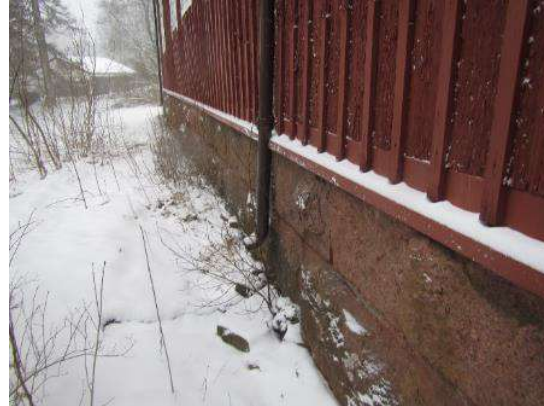
Kuva 5. Julkisivun vierustoilla on kasvillisuutta, joka aiheuttaa kosteusrasitusta julkisivuille.
