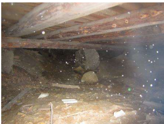
Kuva 13. Yleisesti alapohjan puurakenteet vaikuttivat alkuperäisellä osalla olevan kunnossa.
