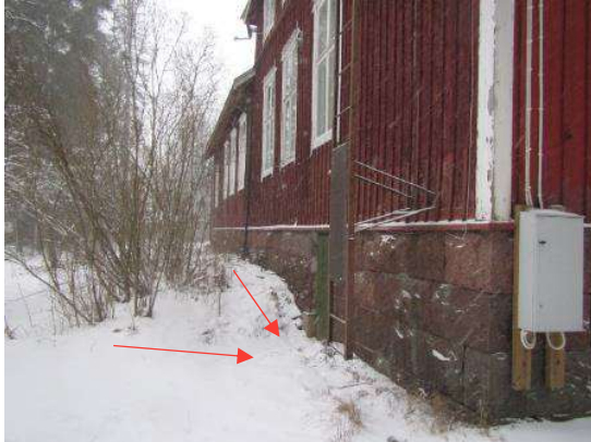
Kuva 4. Lämmönjakohuoneen oven edessä on syvennys, joka kerää sadevesiä.
