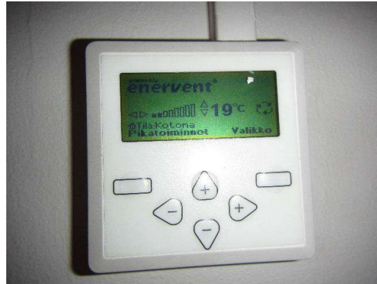
Kuva 78. Ilmanvaihtokoneita ohjataan ohjainpaneelien avulla
