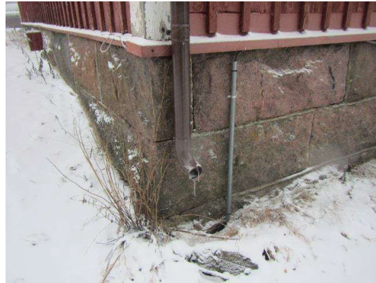
Kuva 76. Syöksytorvien alapäässä ei ole rännikaivoja ja lisäksi se on lyhyt, mistä johtuen roiskuva vesi kastelee sokkelia
