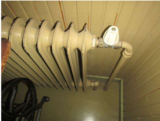
Kuva 65. Alkuperäinen liitepatteri, jossa käsiasäätöventtiili
