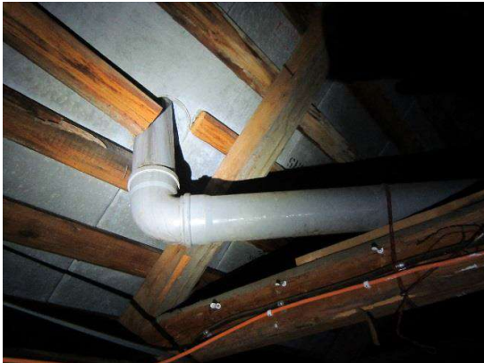
Kuva 73. Kylmässä ullakkotilassa oleva tuuletusviemäri tulee eristää
