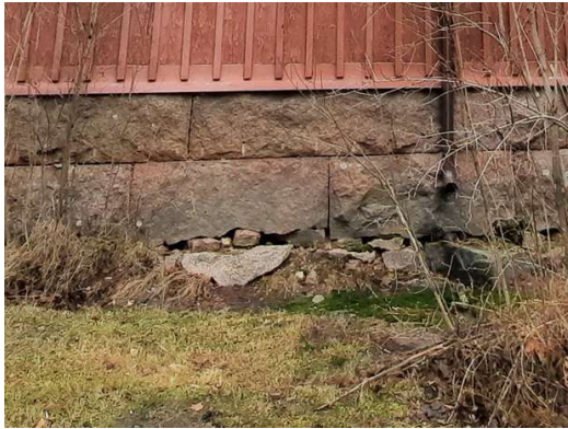
Julkisivun maalipinta on pahoin hilseillyt
