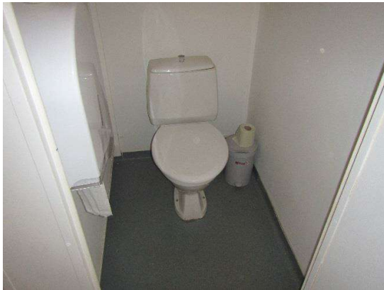
Kuva 71 WC-pöntöt ovat pääosin yksitoimisia
