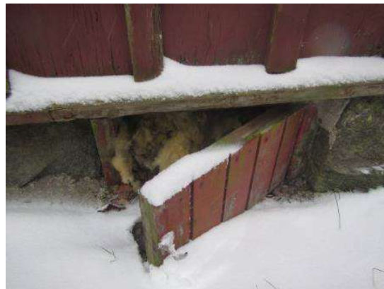
Kuva 3. Pitkän seinän osalla, maanpinnat ovat myös ajan saatossa kohonneet, sillä sokkelinluukut ovat maanpinnan tasossa.
