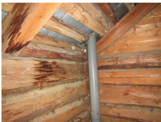
Kuva 47. Eristämätön viemärin tuuletusputki.
