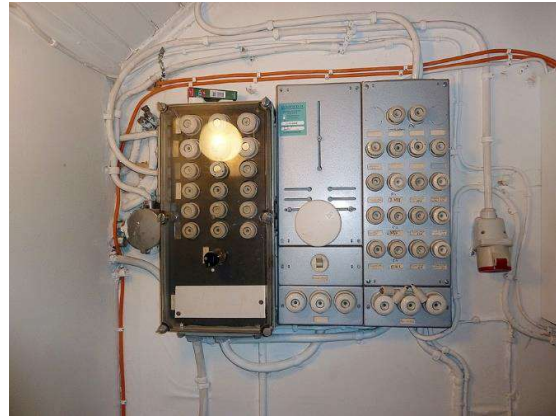
Kuva 88. Vanha pääkeskus alakeskuksena, n. vm. 1950.
