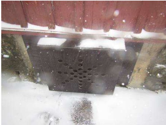
Kuva 19. Ryömintätilan puhallin alkuperäisellä osalla.
