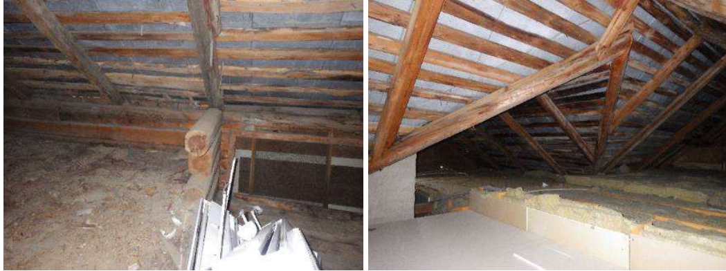
Kuva 33. Yleiskuvat eteläjulkisivun puolella olevasta kylmästä ullakosta. Ullakolta näkee helposti yläpohjarakenteessa tapahtuvan korkotasieron. Ullakolle myöhemmin rakennetun asunnon levyrakenteet ovat myös näkyvissä.
