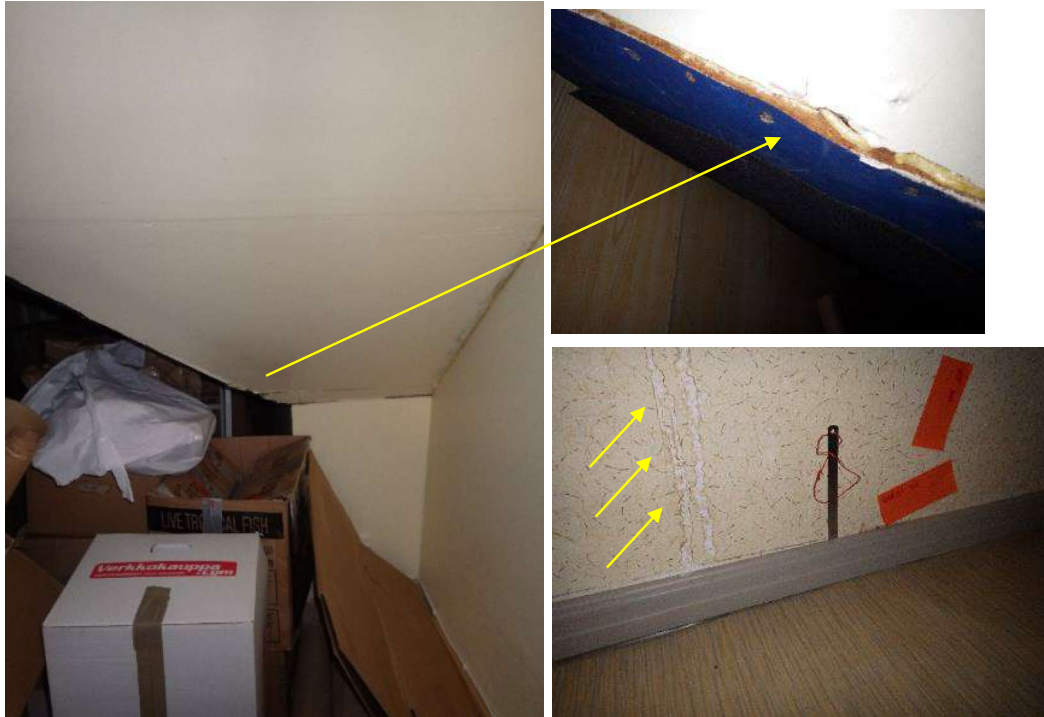
Kuva 29. Pääsisääntäytymisen katokseen liittyvän kattojiirien kohdalla olevissa varastotiloissa on havaittavissa vaurioitumista pintamateriaaleissa. Kattolevytys on kosteusvaurioitunut jiirin alapuolella varastotilassa ja nurkkakomeron seinätapetin pinnassa on valumajälkiä.
