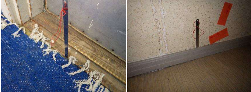
Kuva 18. Välipohjarakenteen sisäkuori ei ole ilmatiivis kummassakaan kerroksessa. Selviä rakoja havaittiin etenkin seinä-lattialiittymissä. Vasen kuva on käyttökiellossa olevan parvekkeen kynnyksen liittymästä ja oikea kuva pienestä komerosta vesikaton jiirin kohdalla. Seinän tapetissa on vesivuotojälkiä.
