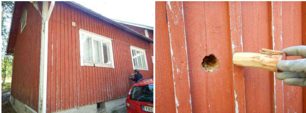
Kuva 22. Laajennusosan luokkahuoneen ikkunoiden välissä on ilmeisesti vanha tapilla suljettu rakenneavauskohta. Rakenne tapin kohdalla on seuraava: lauta ~24 mm – ter- vapahvi – lauta ~24 mm – pahvi –puru ~100 mm.
