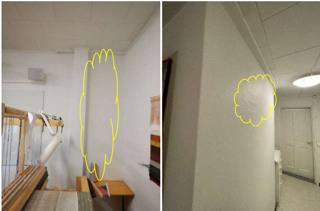
Kuva 26. Toisen kerroksen keittiön, käytävän ja kangaspuut 1 –tilojen nurkkauksessa olevan tiilihormin seinäpinnoilla on kosteuden aiheuttamaa maalipinnan kupruilua. Kupruilukohdista todettiin muita hormi- ja seinäpintoja korkeampia pintakosteusilmai- simen vertailuarvoja, lukemien vaihdella välillä 90...110, vertailuarvon ollessa 50.
