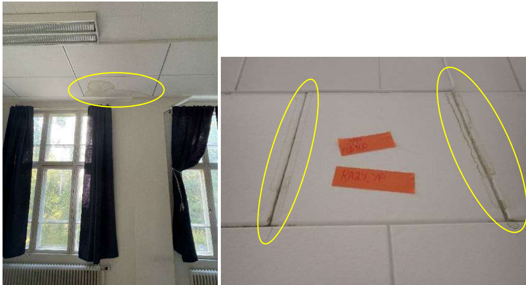
Kuva 34. Salin katon akustolevyssä havaittiin vesivuotojälkiä kutakuinkin kattojiirin alapuolella. Toisen kerroksen kangaspuutilassa 2 havaittiin kattolevytyksessä vesivuotojälkiä.
