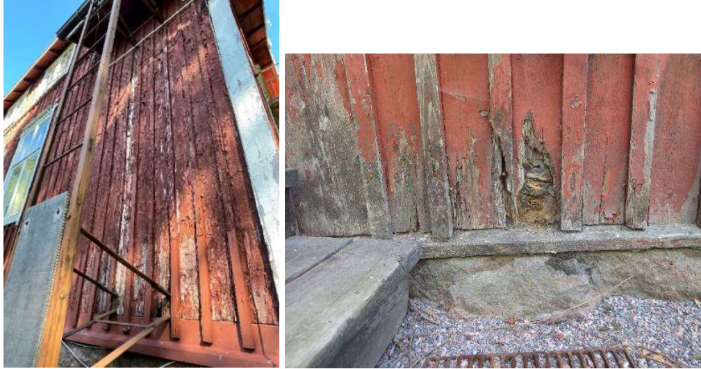
Kuva 23. Seinien alaosien julkisivulaudoituksen ja hirsien lahoaminen on paikoin näkyvissä ilman rakenneavauksia, kuten kattotikkaiden ja pääsisäänkäynnin portaiden kohdalla.
