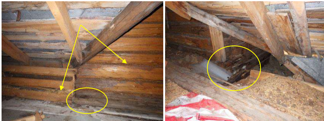
Kuva 30. Salin päällä olevan kylmän ullakon seinien yläosassa kattojiirien kohdalla on kosteuden aiheuttamia jälkiä hirsissä. Itäjulkisivulla ulkoseinien hirsien välissä on laajennusosan puoleisella osalla olkimaista materiaalia pellavariveen sijaan.
