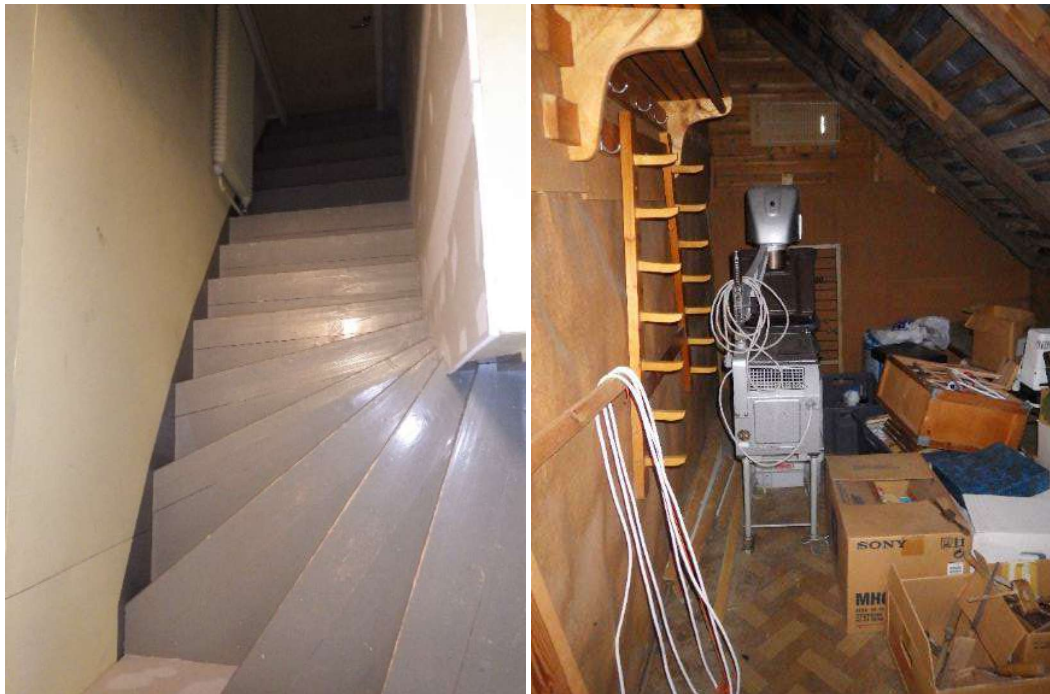
Kuva 28. Toisen kerroksen länsipuolen portaikossa on viimeistelemätöntä kipsilevyseinää. Yläaulasta on kulku kylmään varastoon. Varaston väliseinän pinnassa oleva pahvi kupruili kosteudesta, mutta hirsissä ei tuntunut lahoa.
