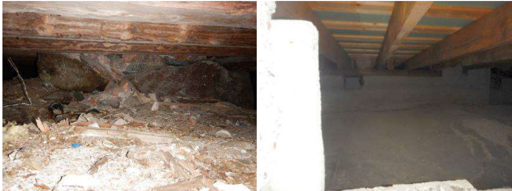
Kuva 16. Alkuperäisen osan länsijulkisivun keskellä sokkelissa olevan ryömintätilan kulkuaukosta havaittiin ryömintätilan pohjamaan päällä rakennusjätettä. Laajennusosan uusitun alapohjan siistikuntoisen ryömintätilan pohjalle on asennettu suodattinkangas.
