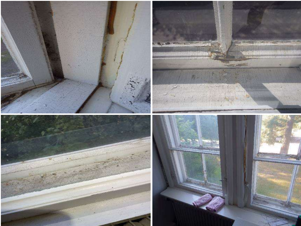
Kuva 24. Ikkunavälien maalipinta on huonokuntoinen ja ulkopuoleissa on alkavaa lahoa. Ikkunaväleissä on paikoin pölyä ja likaa. Joidenkin tilojen ikkunaliittymistä oli havaittavissa voimakasta ilmavuotoa. Käyttäjät ovat tilkinneet ikkunaliittymiä paperilla ja teippauksilla. Osa ikkunoista on vaikea avata ja sulkea.
