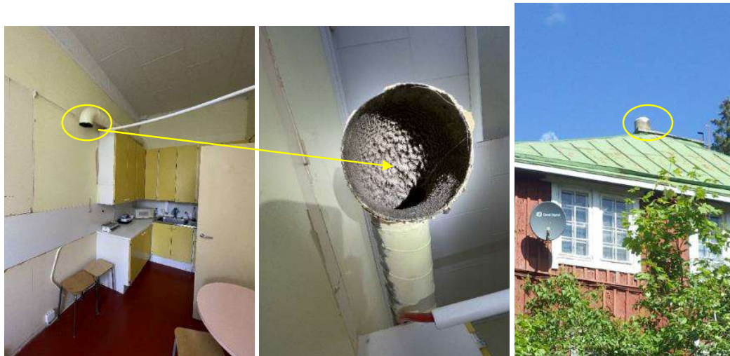
Kuva 40. Ensimmäisen kerroksen keittiön poistokanava on kytketty vanhaan hormiin. Savulla havaittuna kanavassa oli selvä ilmavirtaus poistokanavaan. Poistoilmakanava oli likainen. Maasta käsin tarkasteltuna katolla on hormin kohdalla uudehko iv-kanava.
