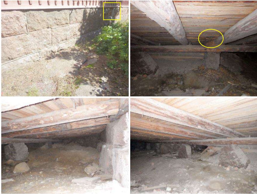
Kuva 14. Eteläpuoleisen julkisivun ryömintätilan luukku on sokkelissa koulumuseon ikkunan kohdalla. Aukosta havaittiin yksittäinen alapohjarakenteen sortuma, joka todennäköisimmin sijoittuu koulumuseon nurkkaukseen. Sortuman takana on lautaseinä. Puurakenteet ovat aistinvaraisesti arvioiden hyväkuntoiset. Vaakahirret tukeutuvat luonnonkiviin.
