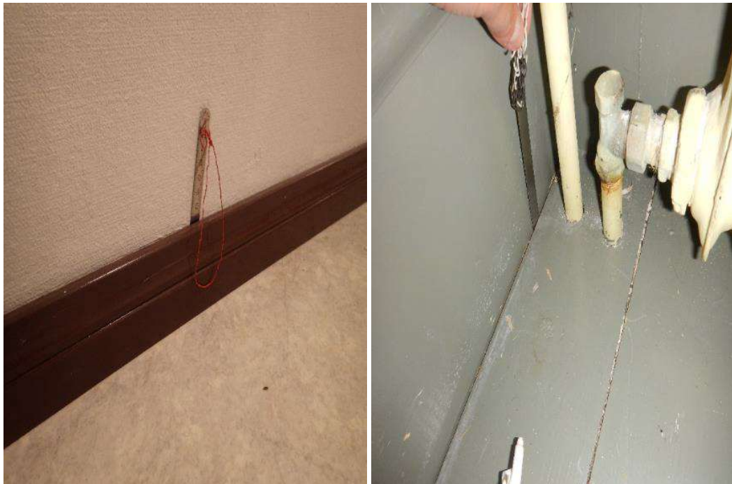
Kuva 17. Alapohjarakenteen sisäkuori ei ole ilmatiivis. Selviä rakoja havaittiin etenkin seinä-lattialiittymissä. Puuportaiden askelmissa on tiiviyspuutteita.
