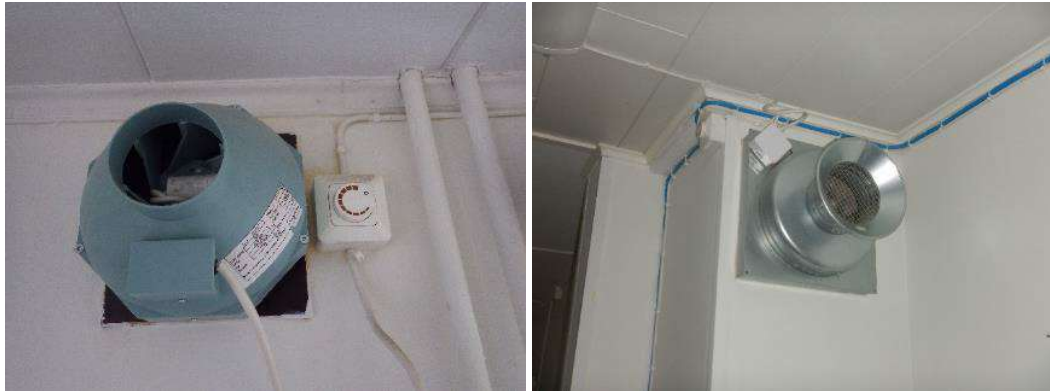
Kuva 41. Ompelutilassa on kanavapuhallin tuloilmalaitteena, joka kytkeytyy päälle samasta katkaisijasta kuin valot. Laajennusosan luokkahuoneessa on kanavapuhallin poistoilmalaitteena, joka kytkeytyy päälle samasta katkaisijasta kuin valot.
