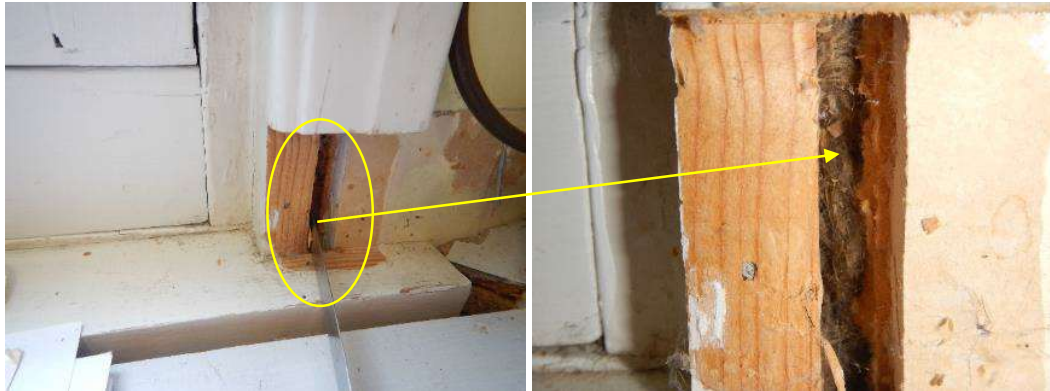
Kuva 25. Ensimmäisen kerroksen keittiön ikkunalistasta on pala pois ikkunan ala- osassa. Ikkunaliittymä ei ole ilmatiivis. Ikkunaväli on tilkitty riveellä. Tutkimusten aikana ei ikkunaliittymästä havaittu merkittävää ilmavuotoa.
