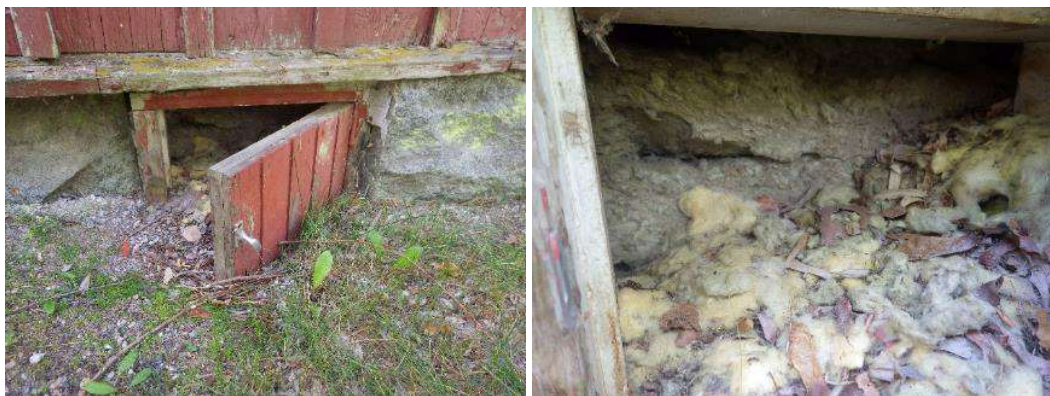
Kuva 15. Sisäpihalla pohjoisen puoleinen rakennusosa on joko painunut tai maanpinta on noussut. Ryömintätilan tuuletusaukko on maanpinnan tasossa. Ryömintätilassa on ko. kohdalla mineraalivillaa ja kuivuneita lehtiä.
