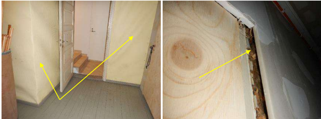
Kuva 27. Toisen kerroksen länsipuolen portaikon yläosassa olevassa aulassa ovat seinien vanhat pinkopahvit kuprulla, samoin aulan viereisen varaston väliseinässä. Varastoon ja kangaspuut-tilaan on asennettu vaneriovet, joiden liittymistä ovat näkyvissä hirsiväliseinien riveet.
