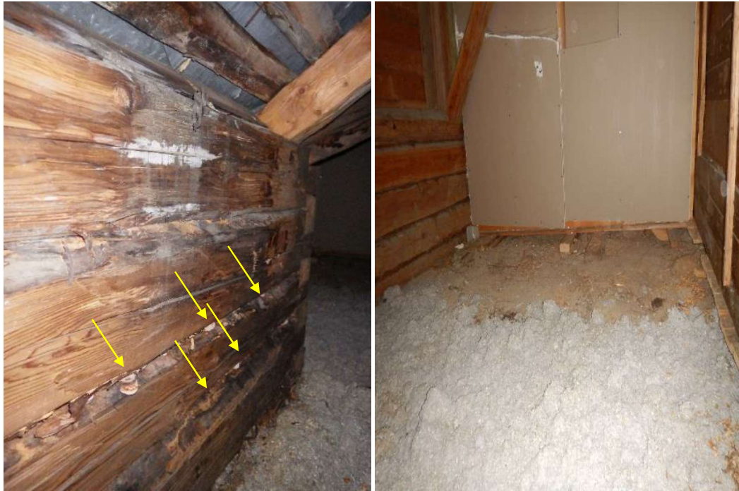
Kuva 31. Toisen kerroksen länsipäädyn pienestä varastotilasta on aukko ullakkotilaan. Ko. kohdalla ulkoseinien hirsipinnassa on kosteusjälkiä ja selvää mikrobikasvustoa, lahottajasientä. Kylmän ullakon perällä näkyy entisen asunnon levyseinärakenne.
