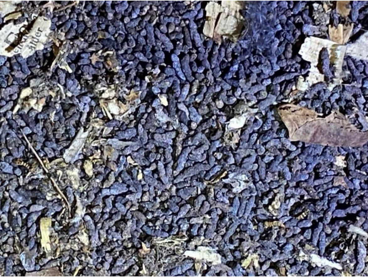
Kuva 9. Asuinrakennuksen toisesta kerroksesta löytyi piipun juuresta satoja lepakonpapanoita.
