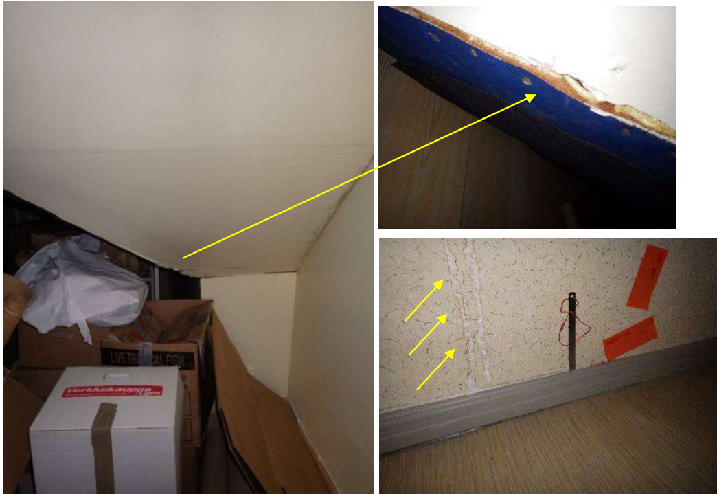
Kuva 29. Pääsisääkäynnin katokseen liittyvän kattojiirien kohdalla olevissa varastotiloissa on havaittavissa vaurioitumista pintamateriaaleissa. Kattolevytys on kosteusvaurioitunut jiirin alapuolella varastotilassa ja nurkkakomeron seinätapetin pinnassa on valumajälkiä.
