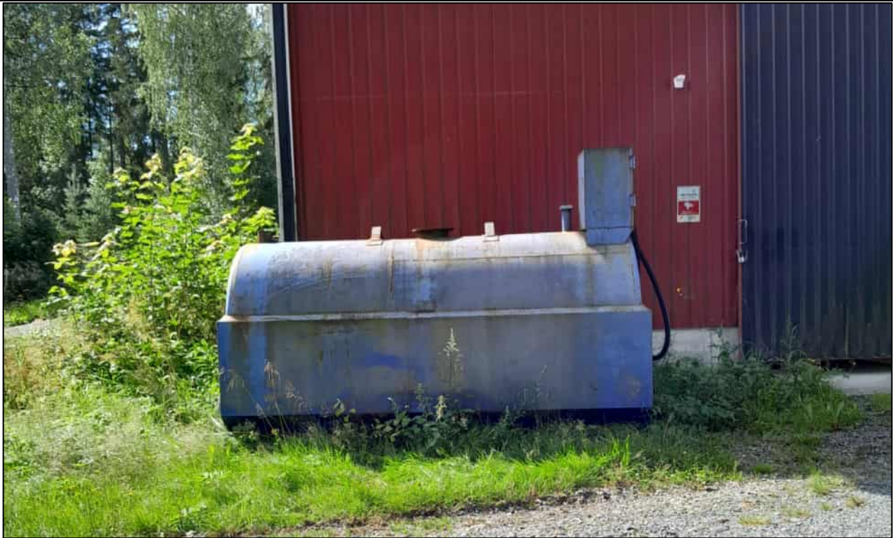
Kuva 23. Farmarisäiliö maanpäällä Nikukällan pohjavesialueella.
