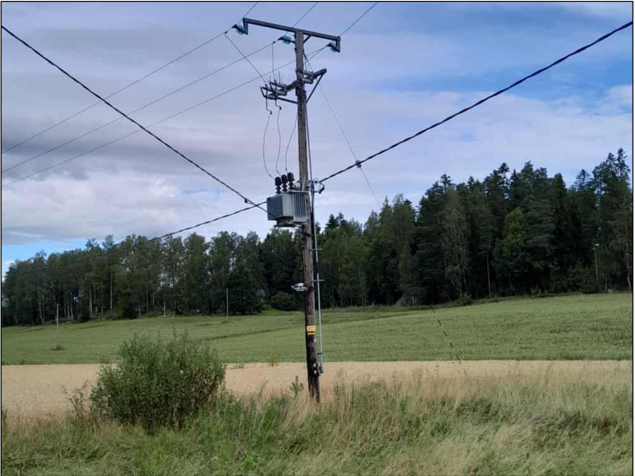
Kuva 26. Pylväsmuuntamo Borgbyn pohjavesialueella.
