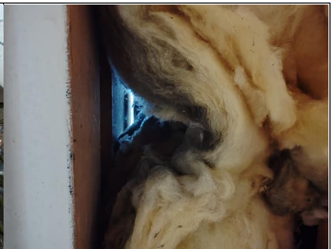
Kuva 9. Epätiivis, kevytrakenteinen ulkoseinäosuus B-käytävän kohdalla. Villakaista on kahden pystyrangan välissä.
