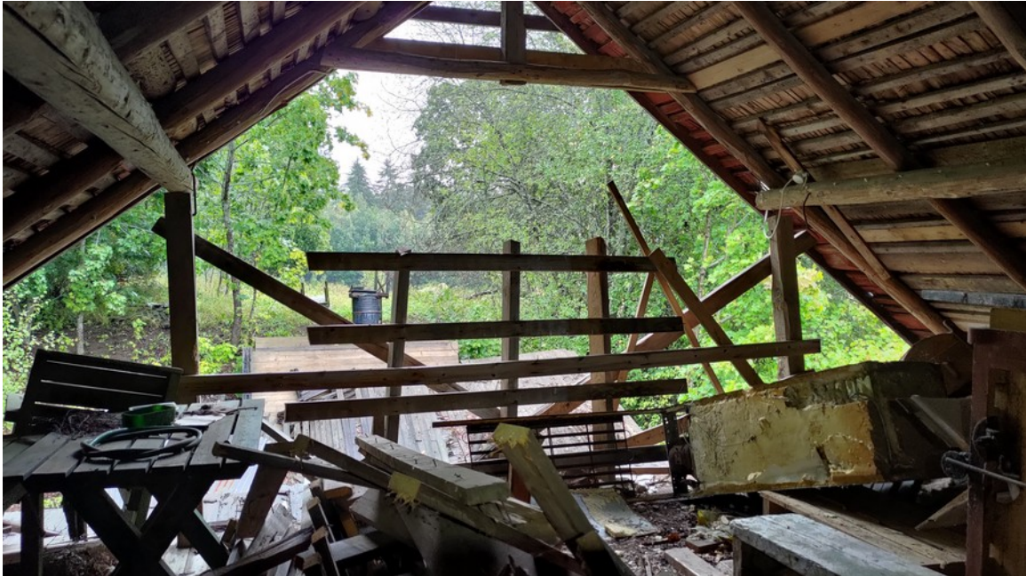
Kuva 6. Navetan toinen puoli on romahtanut.
